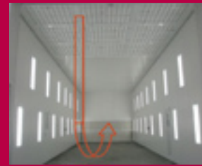
Absaugung an der Rückwand
